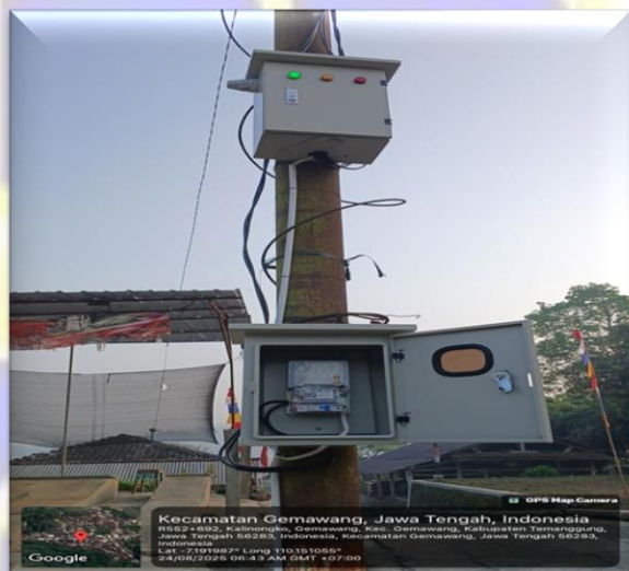
Meterisasi Penerangan Jakan Umum (PJU)
