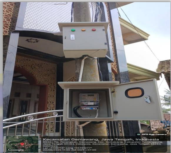
Meterisasi Penerangan Jalan Umum (PJU)
